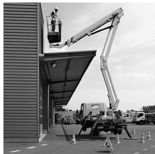
4 Der Arbeitsplatz ist so abzusichern, dass Passanten nicht in den Gefahrenbereich der Hubarbeitsbühne treten.
